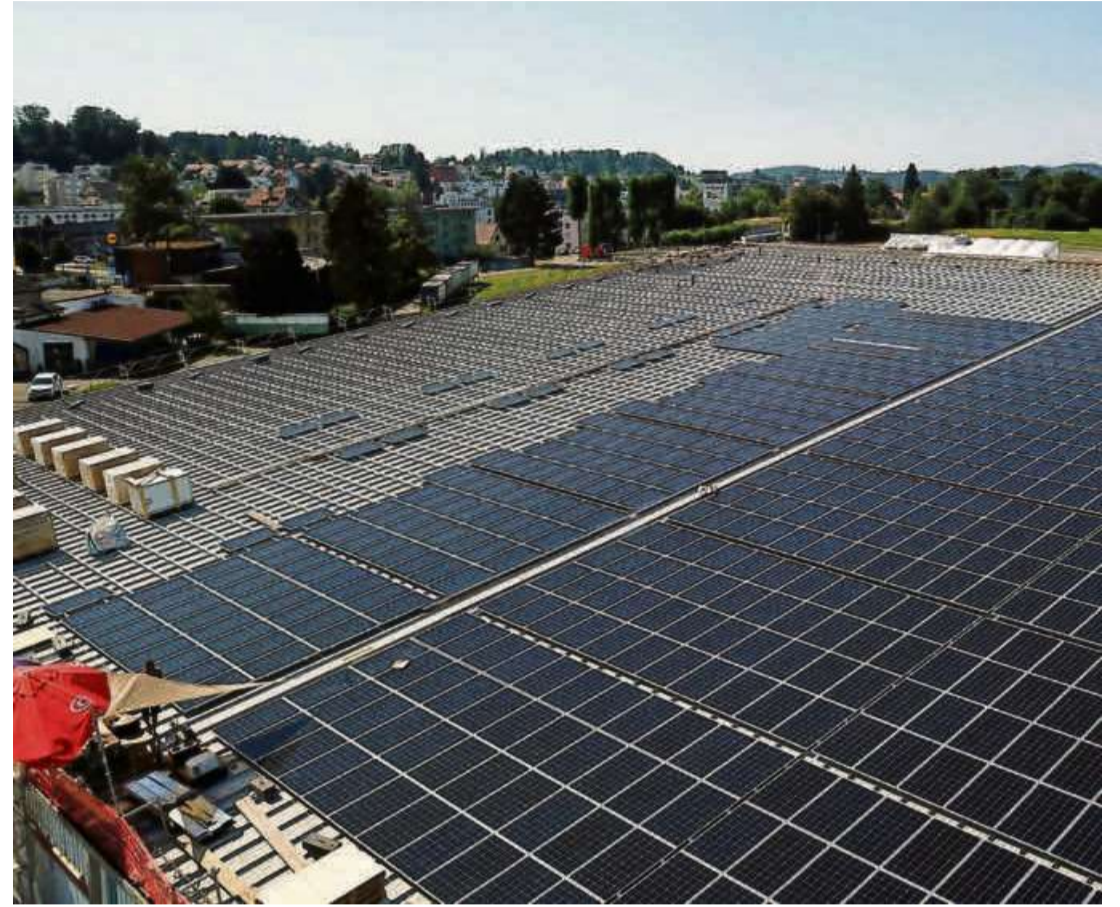
Auf dem Dach der Eishalle Wetzikon entsteht mit 3500 Quadratmetern die grösste Solaranlage des Zürcher Oberlands.
